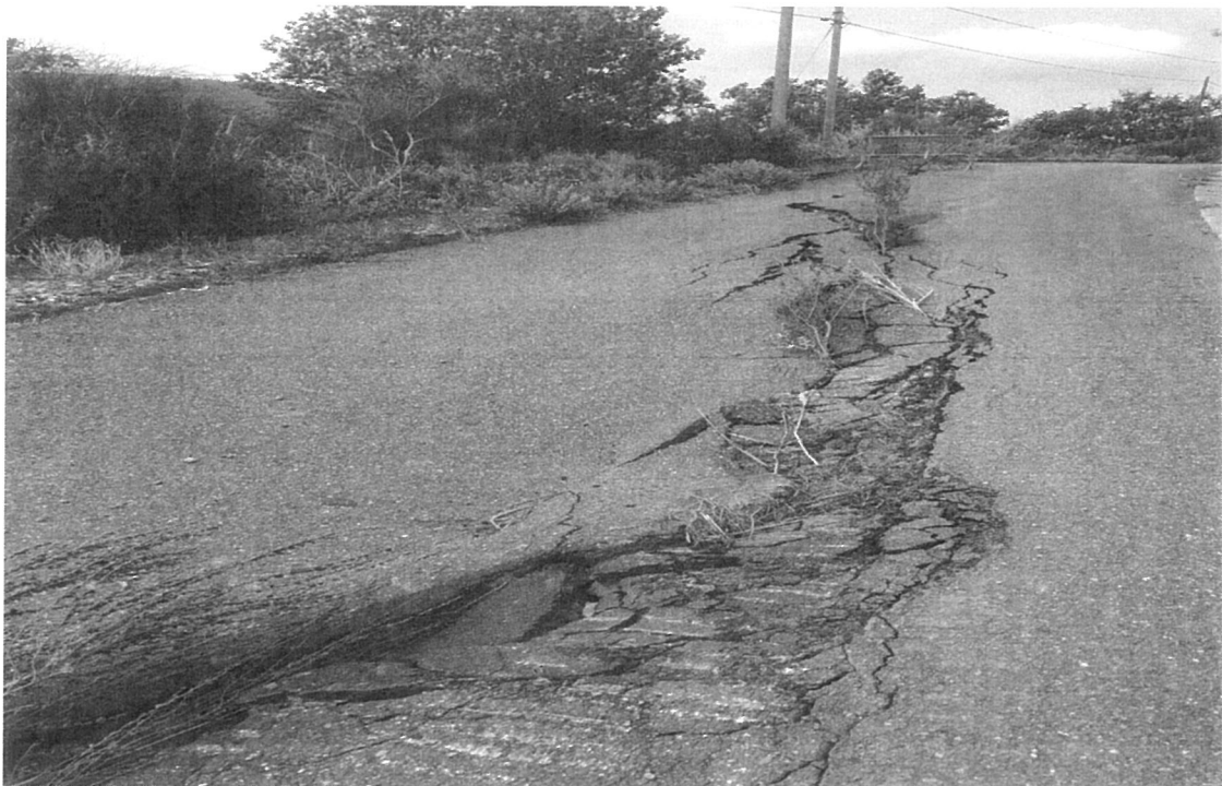
Frana strada collegamento per la contrada Agrosini
