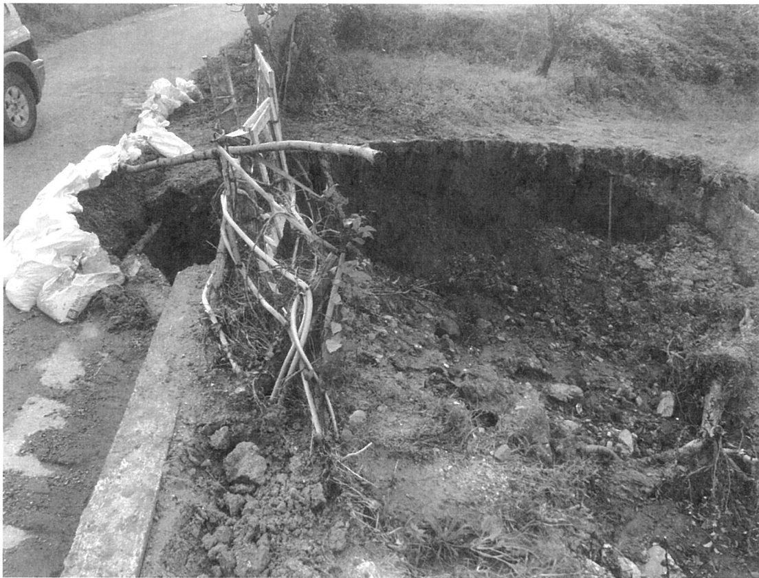
Frana sulla strada di collegamento per la Contrada Rupa - Agrosini
