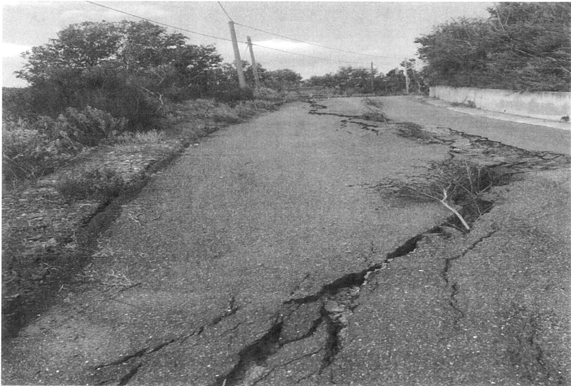
Frana strada collegamento per la contrada Agrosini
